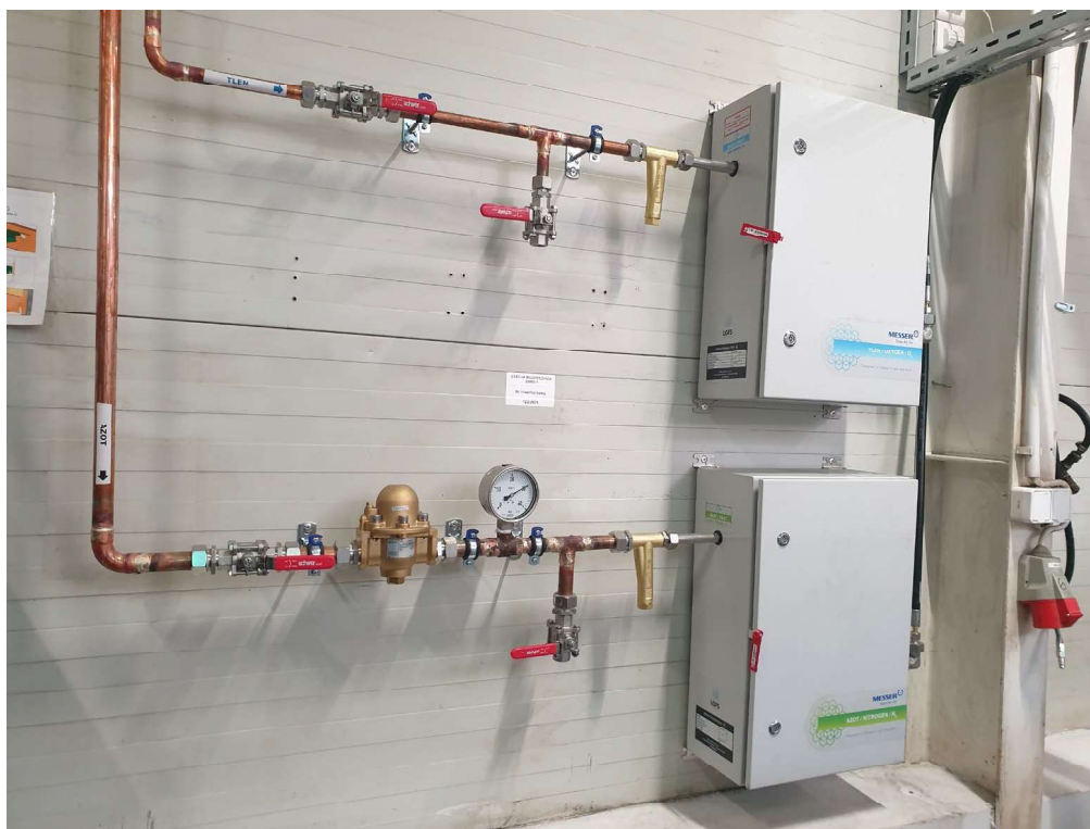
Rys. 4. Gotowy system filtracji zainstalowany u odbiorcy końcowego.
